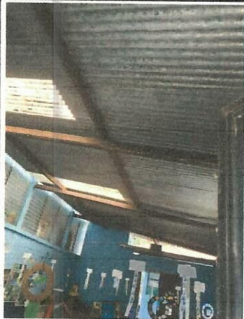
Foto 1: ÁREA CON TECHO EN MAL ESTADO, SE SOLICITA EL CAMBIO A LÁMINA TROQUELADA CALIBRE 26
