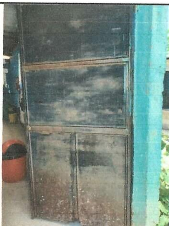
Foto 3: PUERTA DETERIORADA POR LO QUE SE SOLICITA EL CAMBIO DE PUERTA
