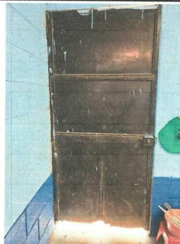
Foto 6: ESTADO ACTUAL DE LA PUERTA, POR LO QUE SE SOLICITA EL CAMBIO
