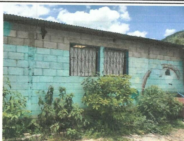
Foto 2: VENTANAS SOLO CON BALCÓN POR LO QUE SOLICITA EL CAMBIO A VENTANAS DE PVC
